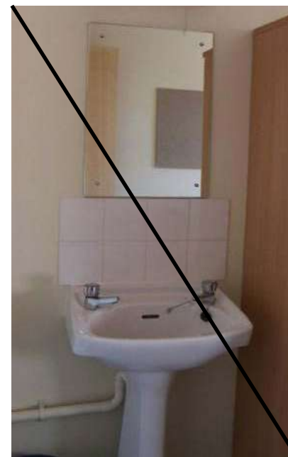
Плохо Раковина с пьедесталом. Фартук из плитки
