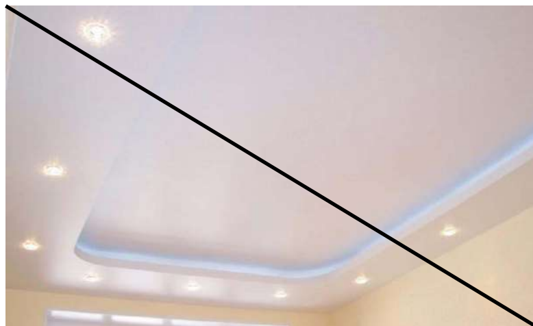
Плохо Многоуровневые гипсокартонные конструкции
