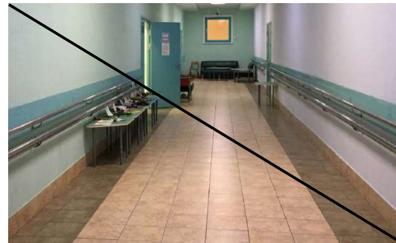
Плохо Керамогранитная плитка с крупными швами
